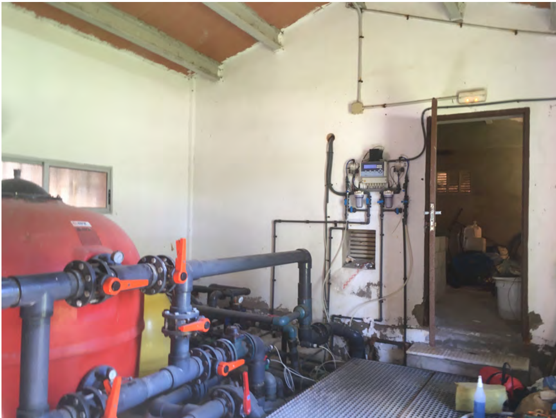
Foto 6. Interior edificio de instalaciones. Al fondo a la izquierda espacio reservado para nuevo equipo de filtrado
