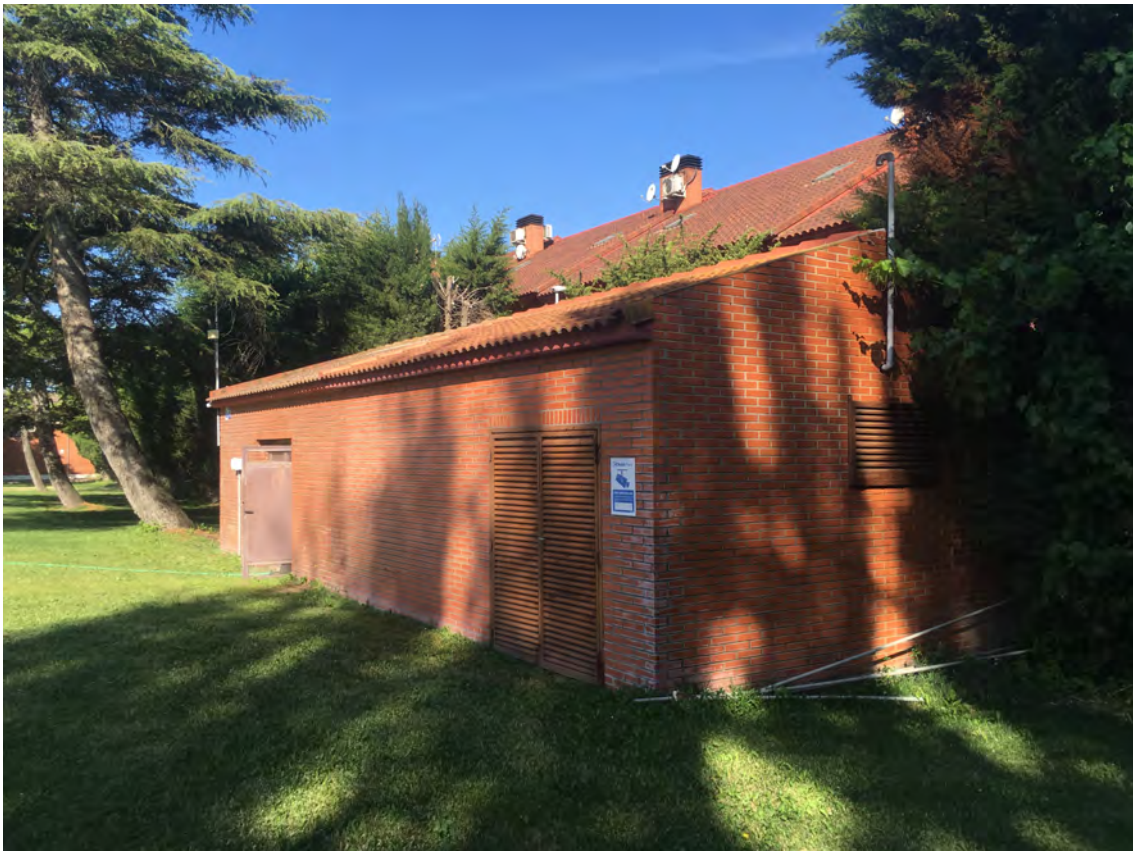
Foto 4. Edificio con instalaciones de depuración
